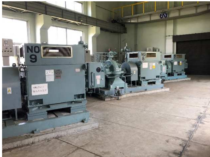
図 7-3 現在設置している配水ポンプ（園田系）
