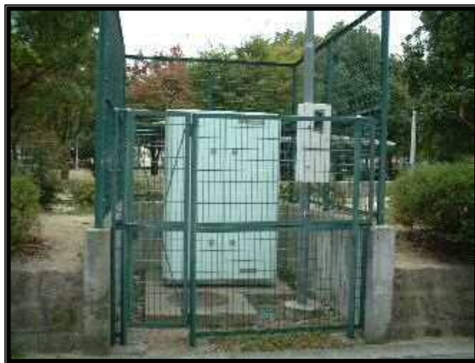
市内に設置している水質自動監視装置
