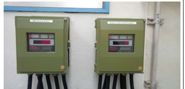
写真 神崎浄水場流量計
