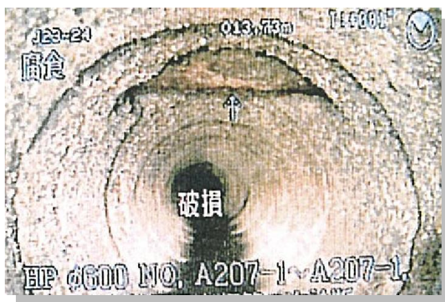
写真1 尼崎市における老朽管の写真
