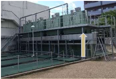
設備の高所設置による浸水対策
