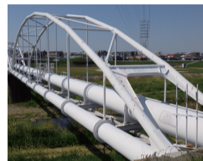
猪名川水管橋
