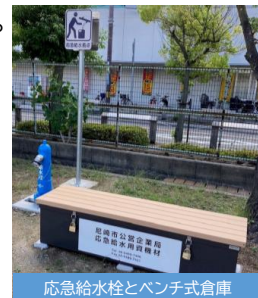
応急給水栓とベンチ式倉庫
