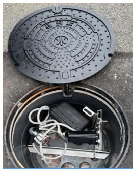
水圧監視装置
