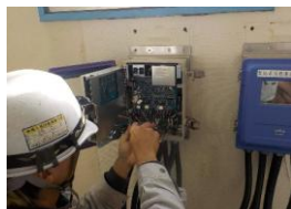
神崎浄水場流量計更新
