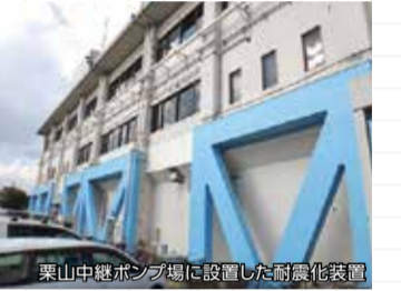
栗山中継ポンプ場に設置した耐震化装置
