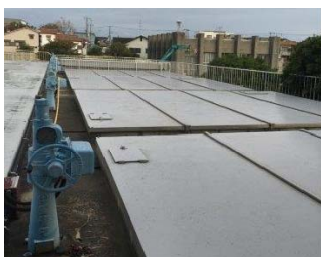
神崎浄水場ろ過池
