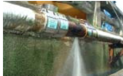
水管橋からの漏水
