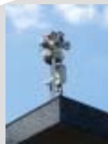
浄水場内監視カメラ
