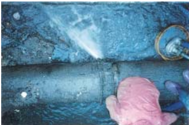
水道管路の被害(500mm)
