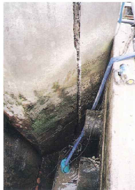
園田配水場の着水井の被害 (クラック発生)
