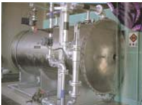
我が国初の水道用オゾン注入設備(昭和48年)
