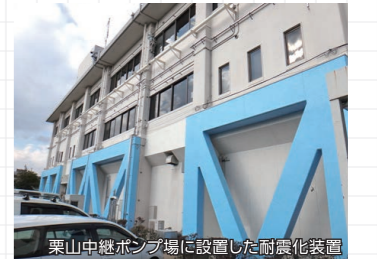
栗山中継ポンプ場に設置した耐震化装置
