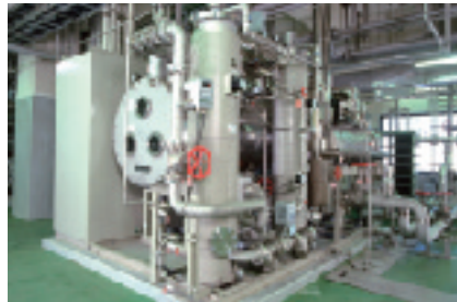
●オゾン発生装置
