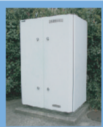
水質自動監視装置
