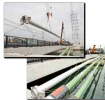
▲白い管が水道管
