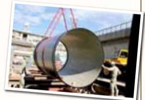
耐震性緊急貯水槽
