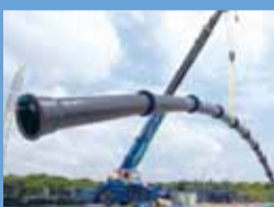
継手部分が可動するので持ち上げると水道管がしなります。
