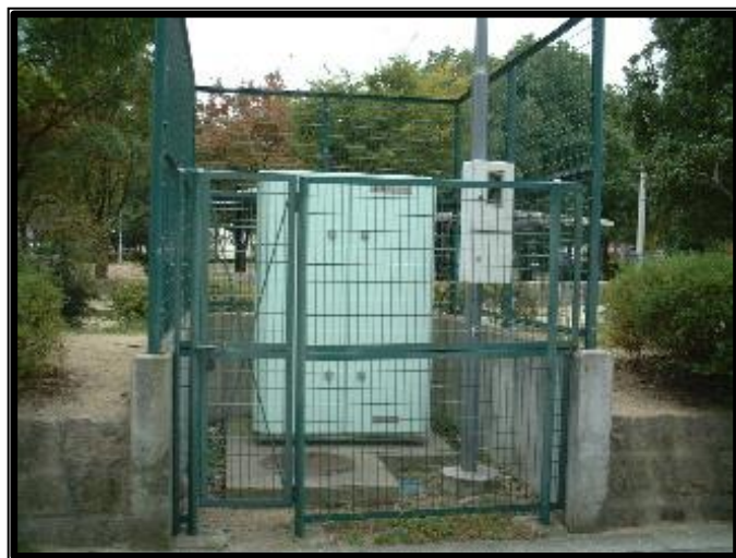
市内に設置している水質自動監視装置
